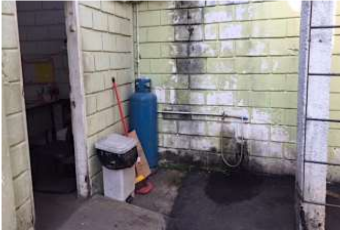
Foto N° 50: Sede da Coordenadoria Regional de Saúde Norte. Bujão de gás instalado em local sem proteção e isolamento.
