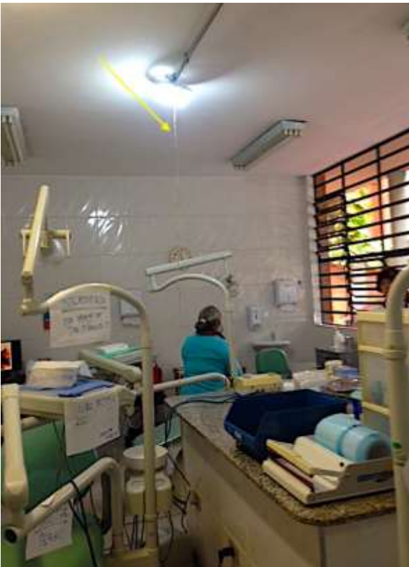
Foto N° 78: UBS Dr. José Barros Magaldi. Sala com fio de energia pendurado no teto.
