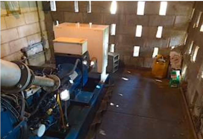
Foto N° 48: Sede da Coordenadoria Regional de Saúde Norte. Grupo gerador de energia sem bandeja de contenção de óleo e combustível.
