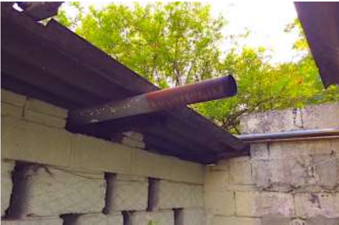
Foto N° 47: Sede da Coordenadoria Regional de Saúde Norte. Escapamento do motor do grupo gerador de energia instalado a baixa altura e dirigido a local de passagem de empregados.
