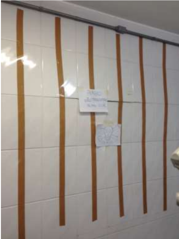
Foto N° 72: UBS Dr. José Barros Magaldi. Sala com azulejo descolando da parede.
